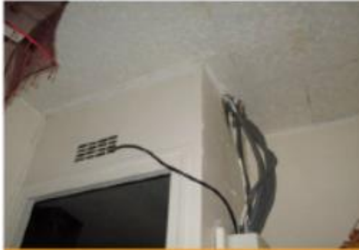
▲ Exemple de logement présentant des infractions au RSD
